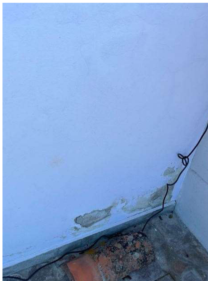
Foto 14 : Dettaglio umidità di risalita
